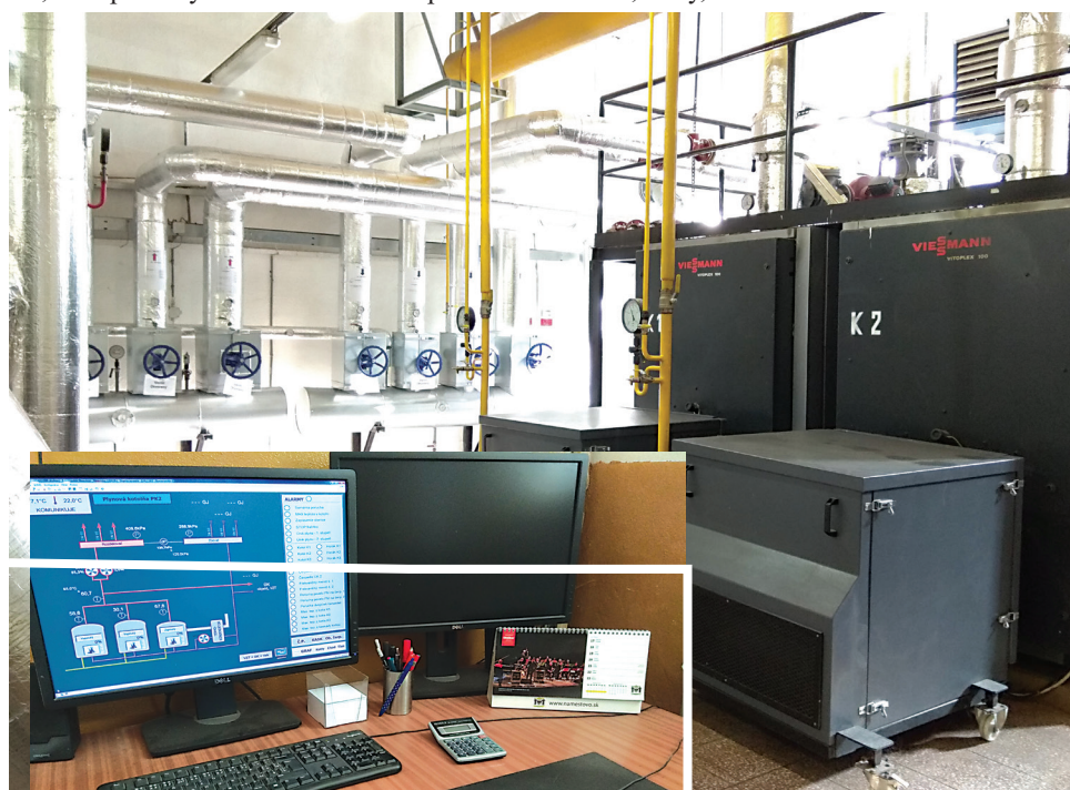
Výroba tepla v plynovej kotolni je plne automatizovaná. Foto: (mš)
